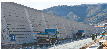
整備工事が進む宮城県石巻市雄勝町の防潮堤。2月8日、白武信幸撮影
